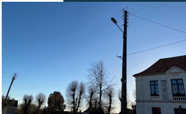
Réseau Basse Tension fils nus
